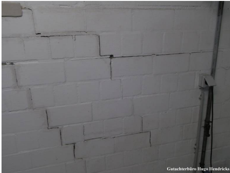
Bild 3: Typisches Rissbild: Fugenriss aufgrund von Treiberscheinungen im Stein
